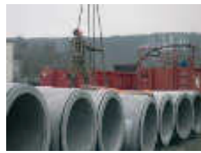
Station de Florival (Grez-Doiceau), IBW. Construction janvier 2005 et technique de pose de collecteurs par fonçage
