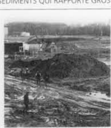
Travaux d'aménagement d'un piège à sédiments à Heverlee en 2005. Photo C.R. Dyle
