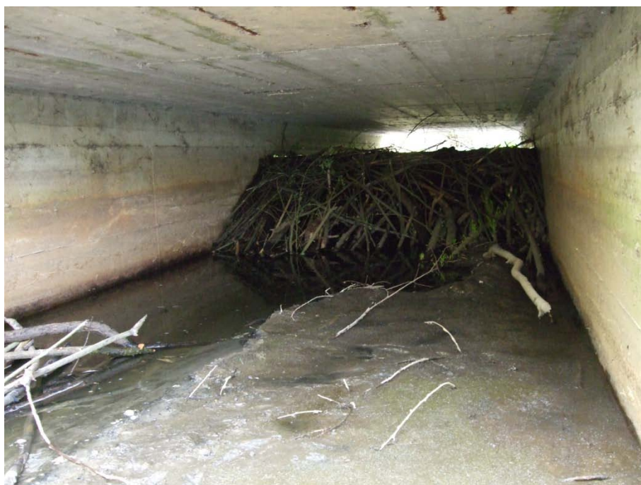
Photo d'un pertuis bouché par l'installation d'un barrage ce qui risque en cas de crues de poser un problème d'inondations de route et dès lors de sécurité publique
